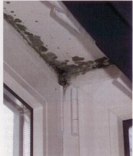
Spotartiger Schimmelbefall in einer Außenwanddecke
