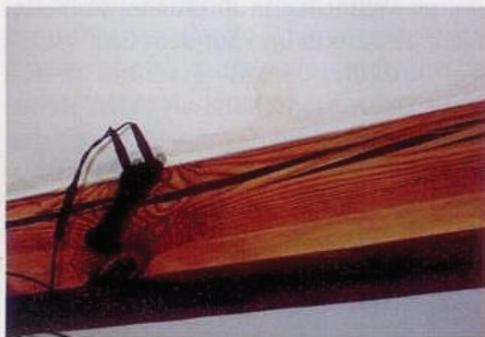
Feuchterand an der Gipskartonbekleidung in einem ausgebauten Dachgeschoss eines Altbaus
