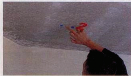
Massiv vom Schimmel befallene Gipskartonunterdecke
