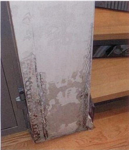
Längere einwirkende Feuchte hat zu Korrosion der metallenen Putzschienen an einer Wand im Souterrain geführt.
